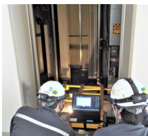
<エレベーター点検中>
