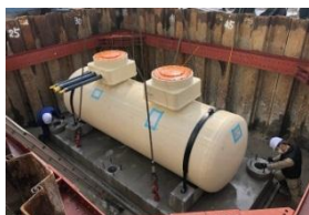
非常用自家発電機の燃料地下タンク
