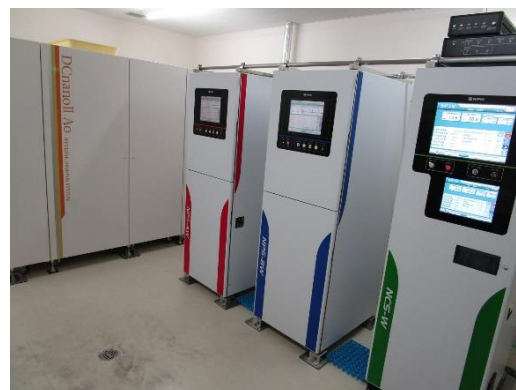
透析液製造室
