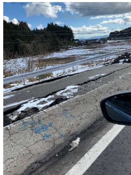
移動中の車内から見た道路の亀裂
